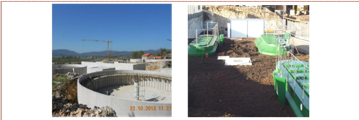
Abbildung 5.25: Kläranlage Nikšić (links) und Kläranlage Žabljak (rechts) Quelle: godina, Stand 02/2018 [87]
